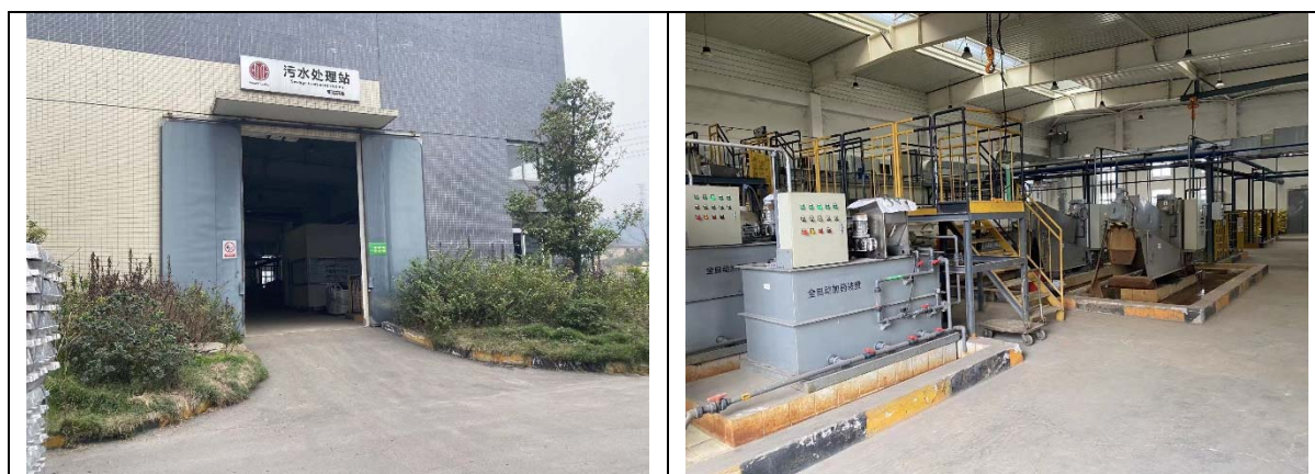
图4.1-2 项目污水处理站
