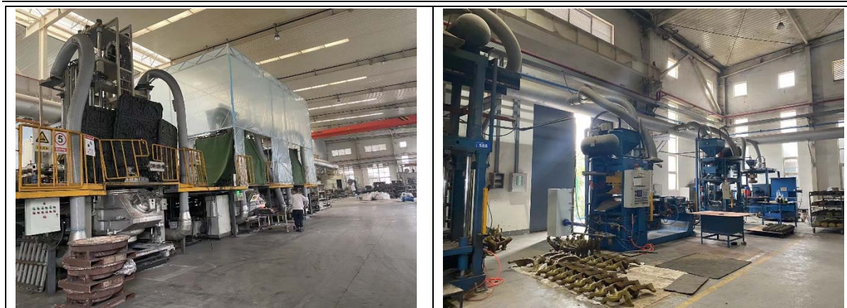
图 4.1-3 废气治理设施图
